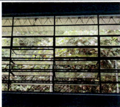
Foto 7: SUSTITUCIÓN DE VIDRIOS EN VENTANAS QUE ESTAN QUEBRADOS
